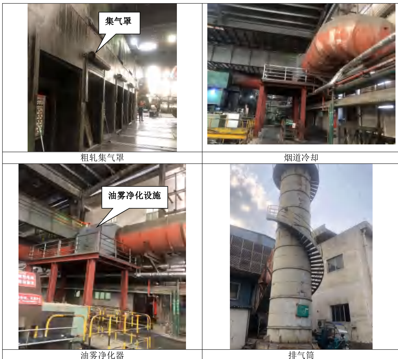
图 3.1-1 粗轧生产线油雾治理措施
