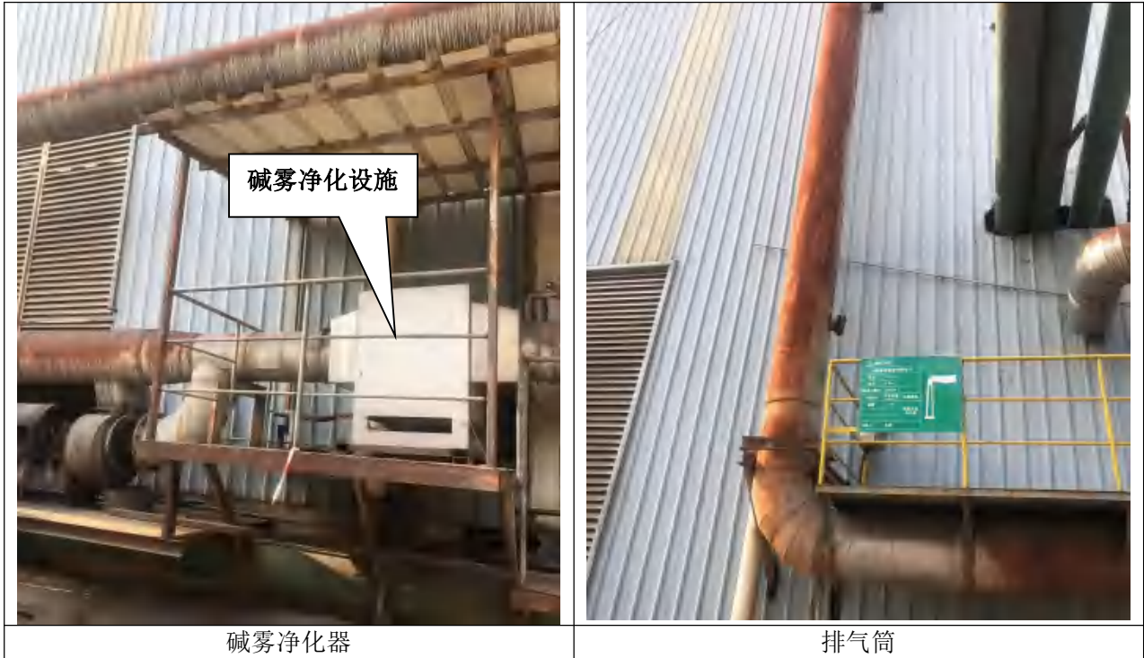
图 3.1-6 粗轧生产线油雾治理措施
