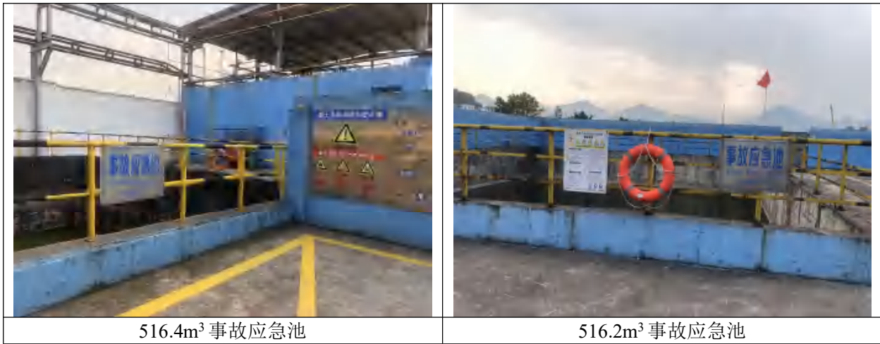
图 3.6-1 液氨罐区风险应急设施
