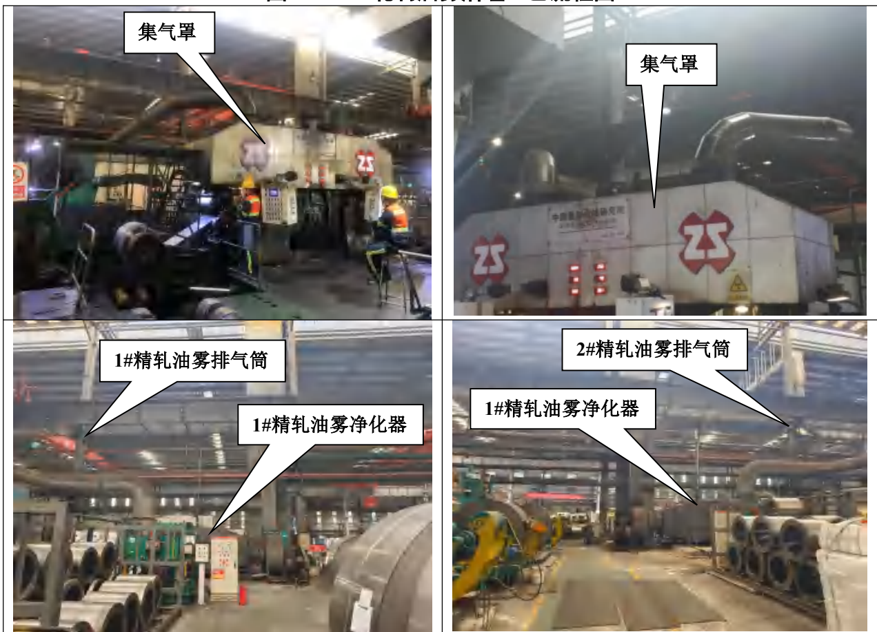
图 3.1-3 精轧生产线油雾治理措施
