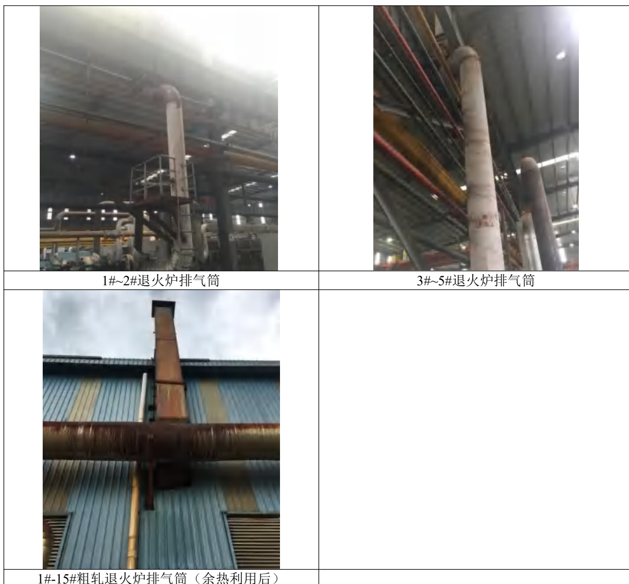
图 3.1-4 退火炉燃烧烟气治理措施
