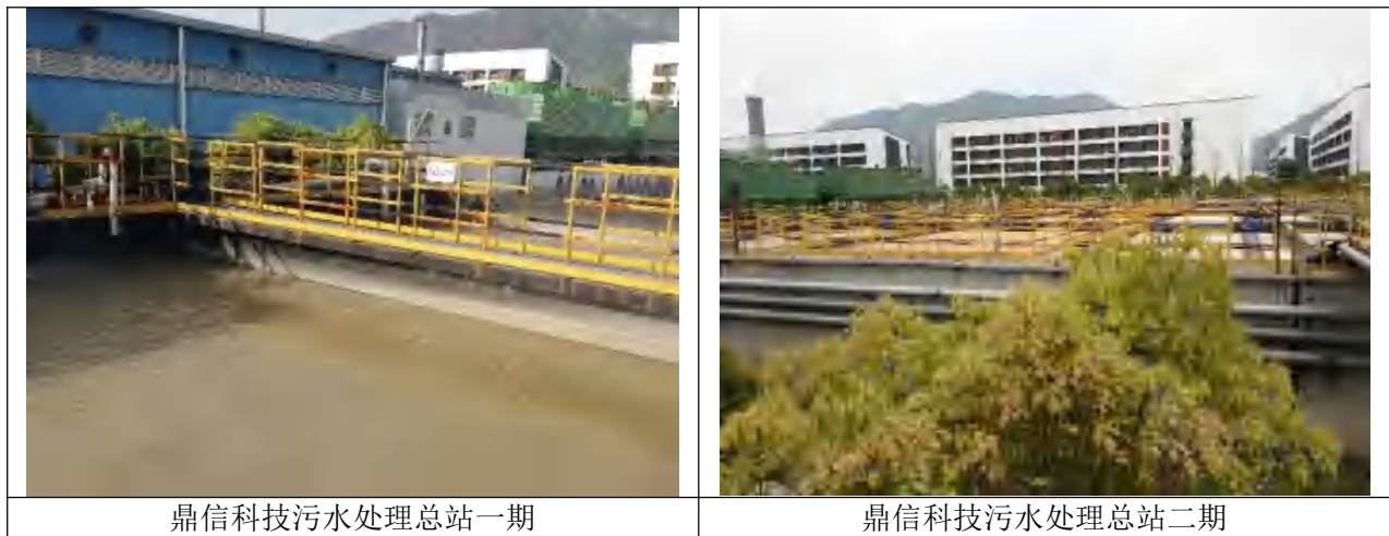
图 3.2-4 鼎信科技污水处理总站
